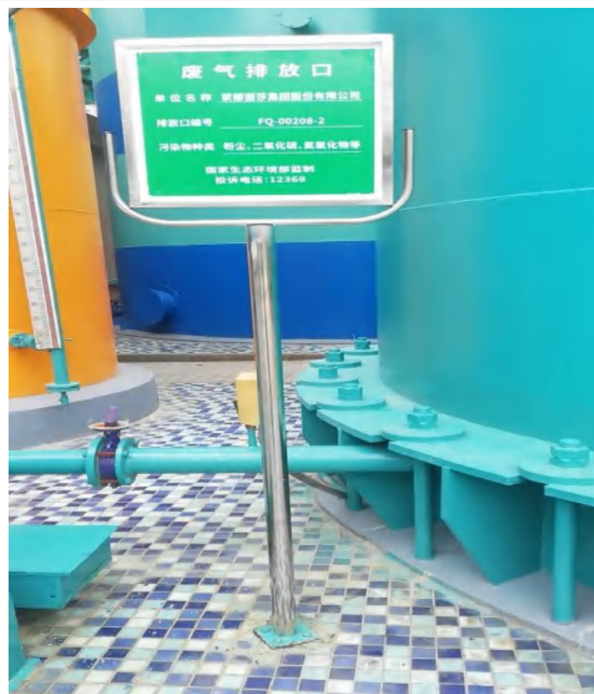
2#排气筒废气排放源
